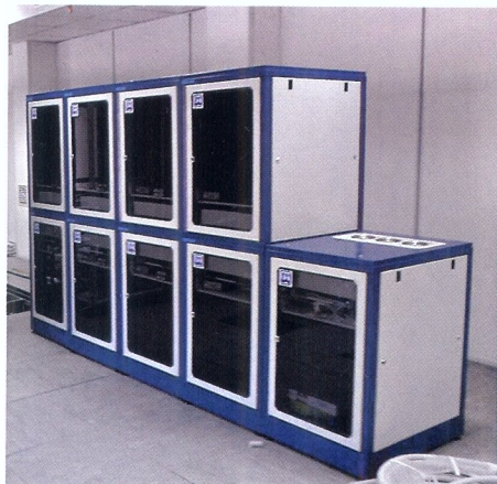
ПТК, установленные в ЛАЗ-е КДП аэропорта Сочи (Адлер)
